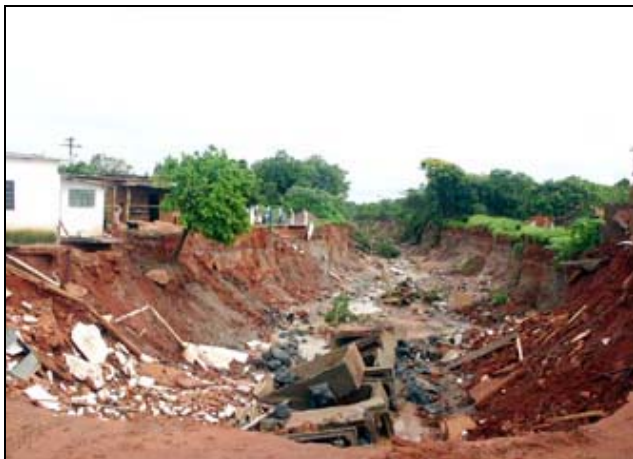
Foto 1: Rompimento da galeria do J. Santo Expedito. Fonte: Prefeitura Municipal de Jales, 2006.
