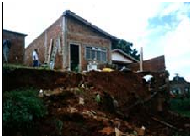
Foto 6: Muro de arrimo derrubado pela enxurrada.
