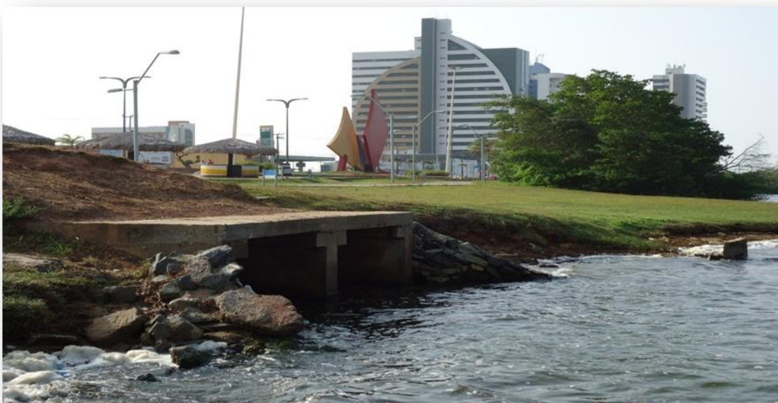
Figura 30. Bueiro duplo celular ligando a Lagoa ao Igarapé da Jansen. 2011. Foto: RIO BRANCO, 2011.
