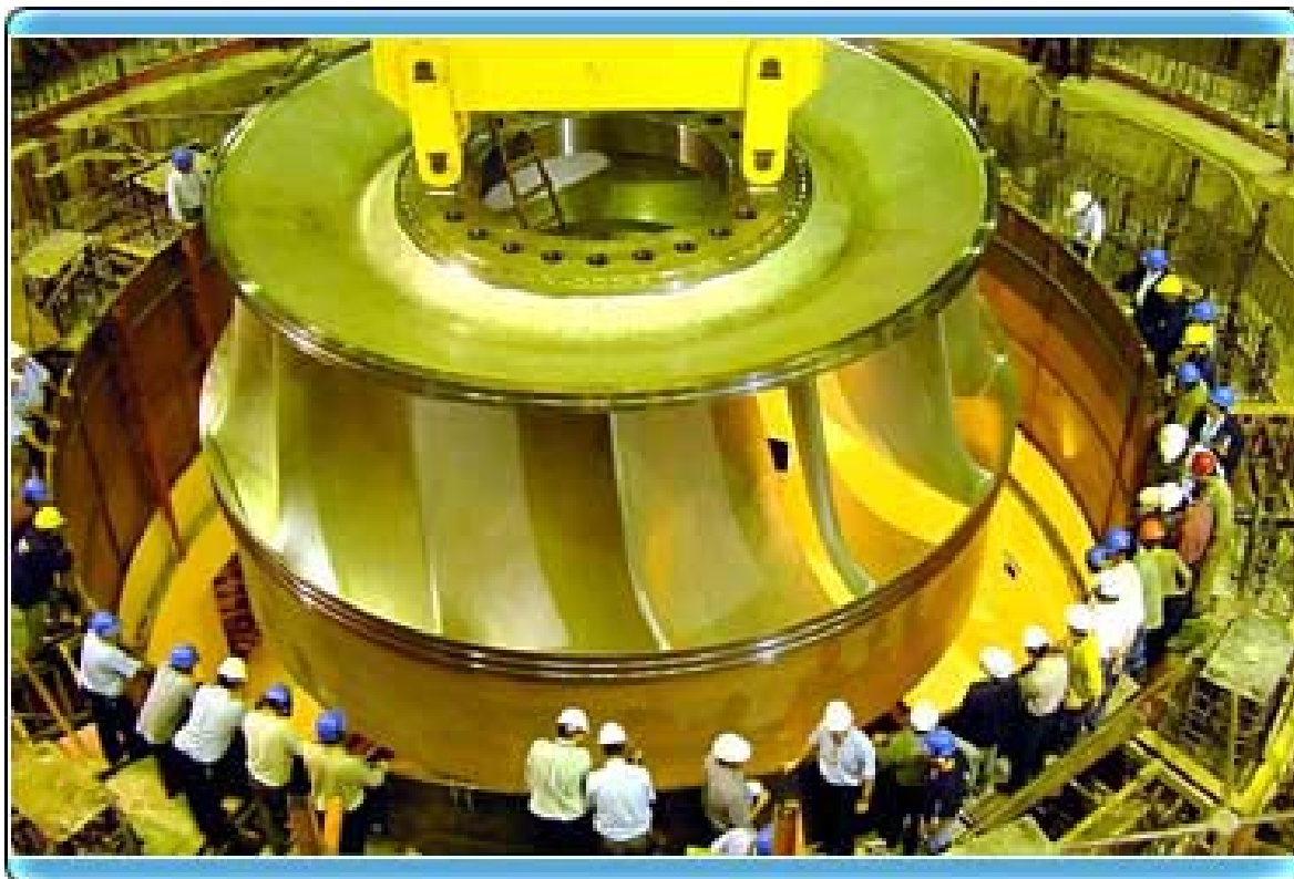
FIGURA 3: GERADOR DA USINA HIDRELÉTRICA DE ITAIPU FONTE: ITAIPU ENERGIA
