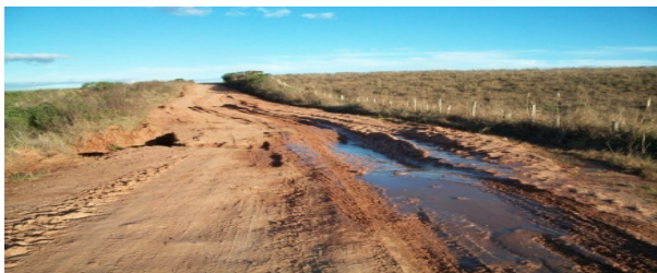
Figura 3- Foto do problema, coordenadas: E= 695237,018 m e N= 6617052,641m. Data: Julho/2011
